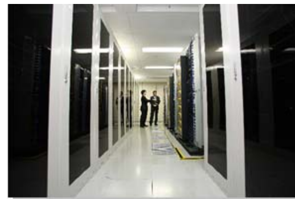
ずらりと並ぶサーバーラック
