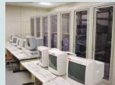
システムラック・通信機器
