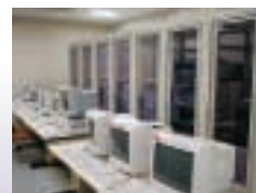
システムラック・通信機器
