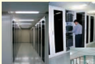
サーバラック
